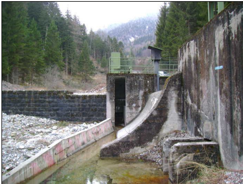
Figura 19. Opera di captazione sul torrente Adanà a monte di Roncone.
